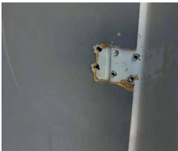
Vidljivi tragovi demontaže u utovarnom prostoru
