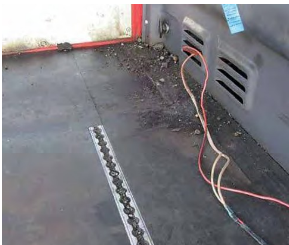
Nepravilno ožičenje izvedeno od strane korisnika
